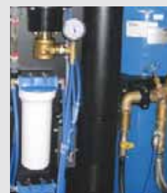
Wasserenthärtungs- und Osmoseanlage
