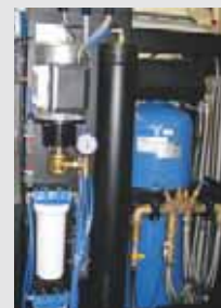
Wasserenthärtungs- und Osmoseanlage
